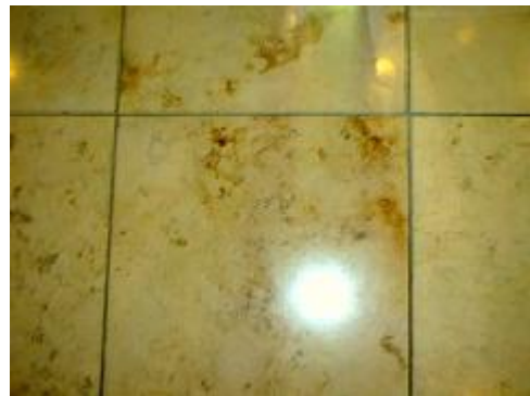
レジンテラゾーの破損は 破片を保管しておく 破片が足りないと修復が目立つ
