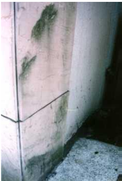
砂岩の苔は高圧洗浄時に 圧力に注意
