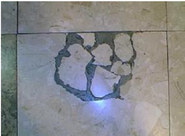
ひびのある石材の内部錆
