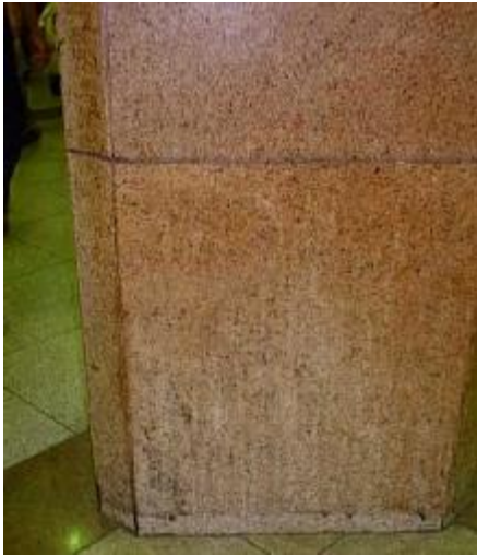
駅の白花崗岩の柱の汚れ 表面の汚れが7年間で少しずつ浸透
