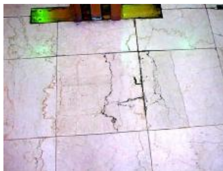
石材の浮きによる 割れ
