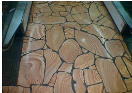
このような施工を乱形と呼ぶ この場合、目地の汚れがトラブルになり易い
